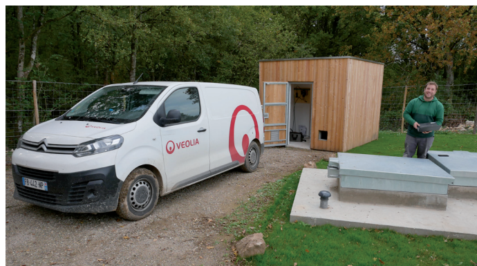
Puits du bois – captage d'eau
